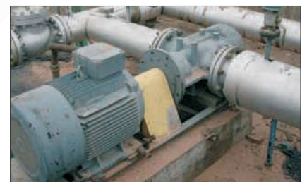
2 3 FO Насос перемещения L3NG
